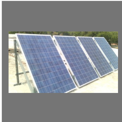
Solar Rooftop 1kw
