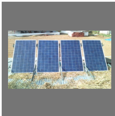
Solar Rooftop 2kw
