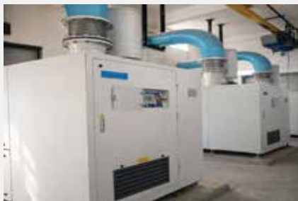
25 MLD Dafnala STP Project
