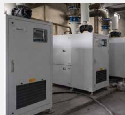
Balotra CETP SBR Blowers
