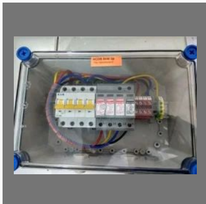
ACDB AC Solar
