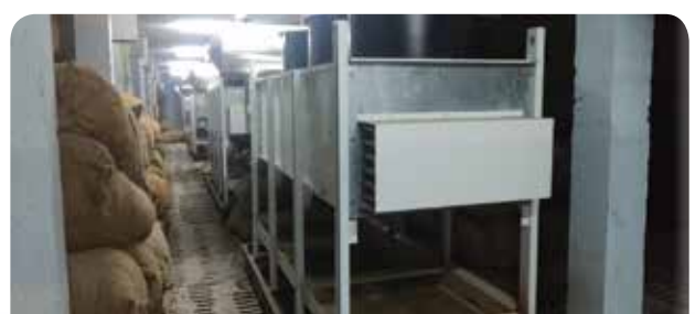
Bhagyodaya Cold Storage, Raichur (KA)
