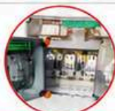
SOLAR ACDB & DCDB
